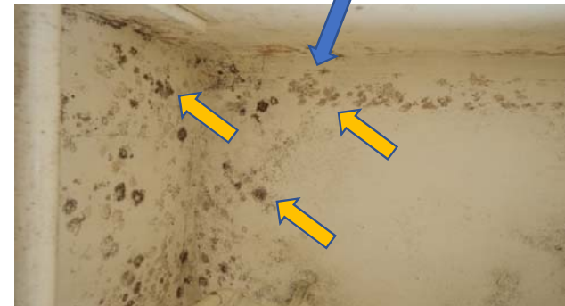
漆面水泥牆上可見的不規則霉斑，但是每個霉落都有清晰且呈圓形的邊界(箭頭所示)。
