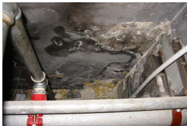
圖2.3d：因上層過去曾發生水浸而受水患破壞的天花
