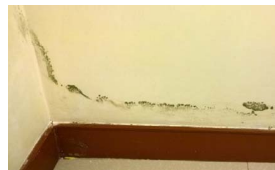
牆壁木腳受水浸破壞並導致附近的牆面有霉菌滋生
