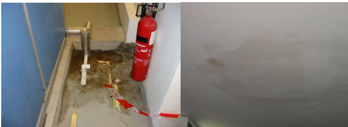
圖 2.3a：風櫃房現有的漏水問題及風櫃房下層天花板有水漬
