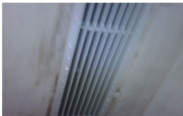
圖2.2a：空氣擴散器表面的冷凝水
